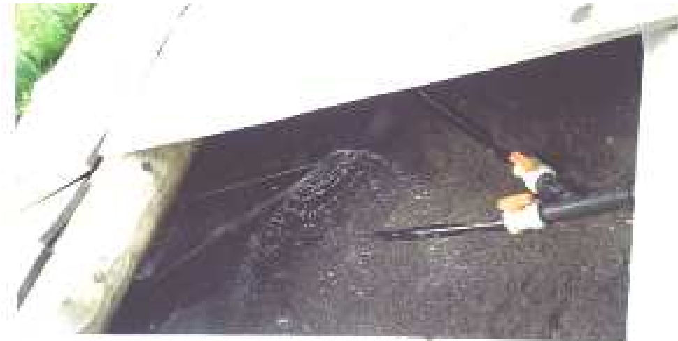
Abbildung 4: Sandfilter mit Drehsprenger
