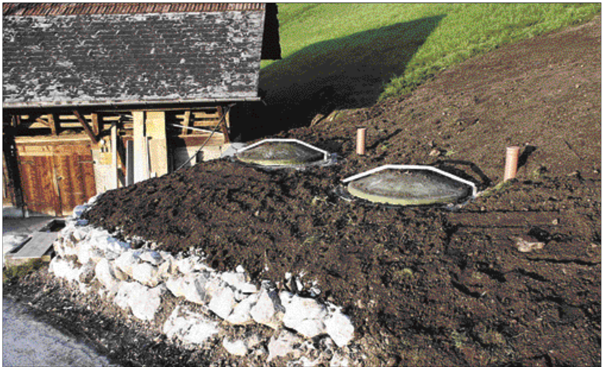
Zwei nutzlos gewordene Raufuttersilos erfüllen hier einen neuen Zweck als Sandfilter-Kläranlage bei einem Bauernhof im ländlichen Raum im Kanton Obwalden.
